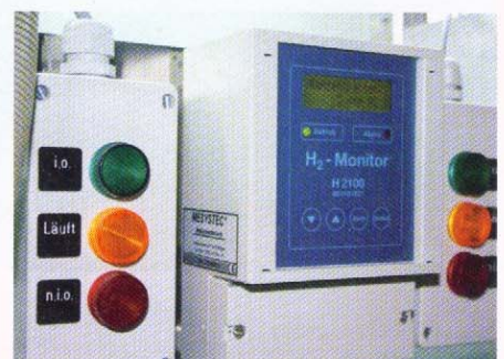
Der H 2 -Monitor misst kontinuierlich die H 2 -Konzentration in der Anlage
